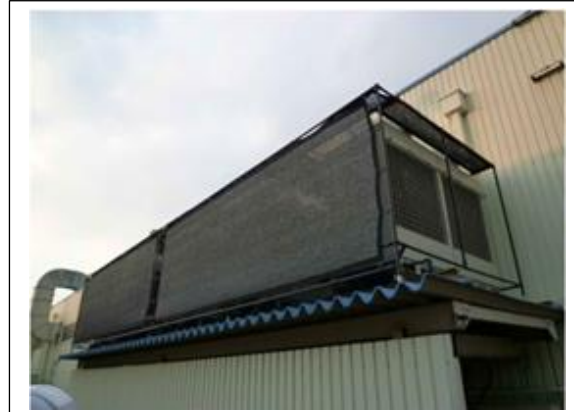
空調の室外機
