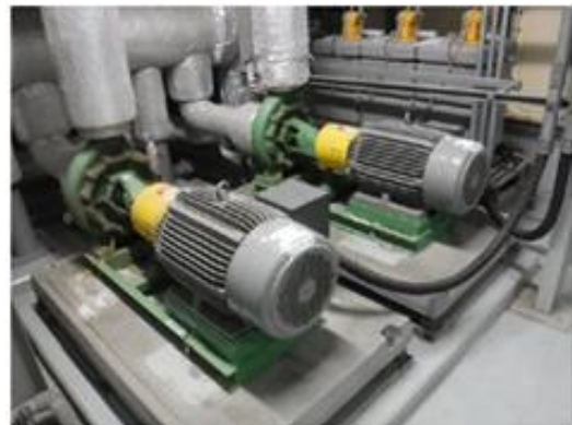
更新したポンプの写真(37kW×2台)
