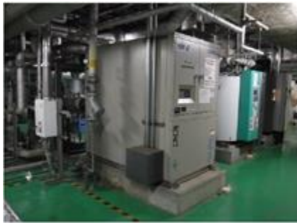
導入した排熱回収型冷温水チラー
