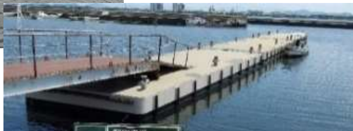
浮棧橋の長寿命化
