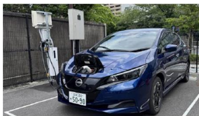
公用車の電動化 EV急速充電器
