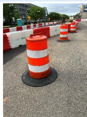
道路工事用バリケード、 英語では「オレンジバレル」
