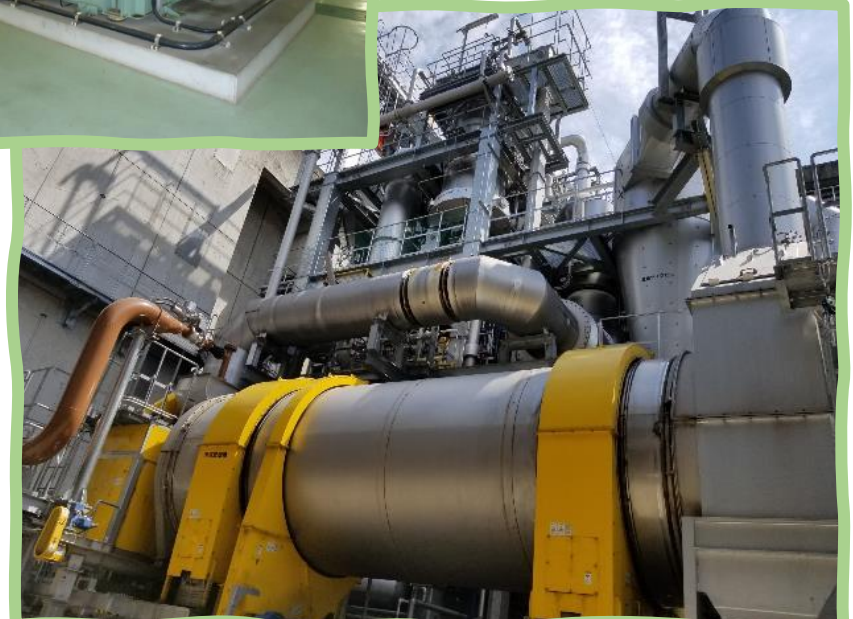
汚泥燃料化施設
