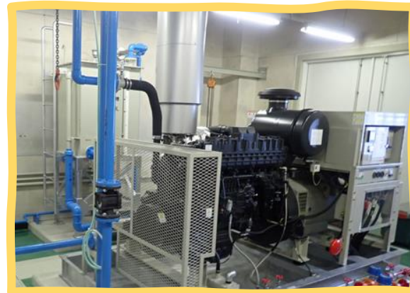
中継ポンプ場 自家発電設備
