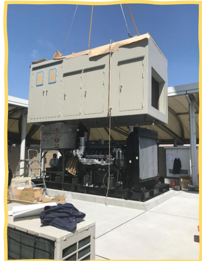
びわこボートレース場 自家発電設備
