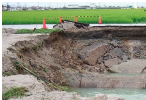
管水路の破損による農道の陥没
