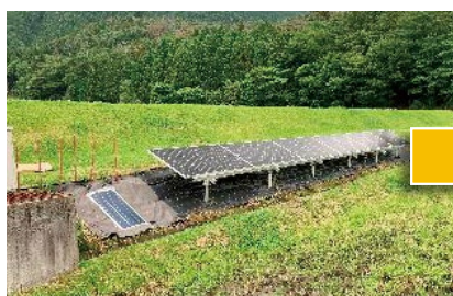
太陽光パネル・太陽光シート
