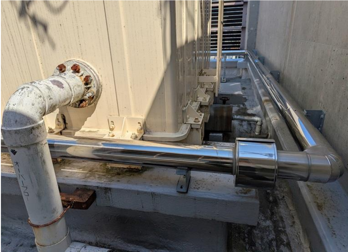
11揚水管およびオーバーフロー管 2（南面）
