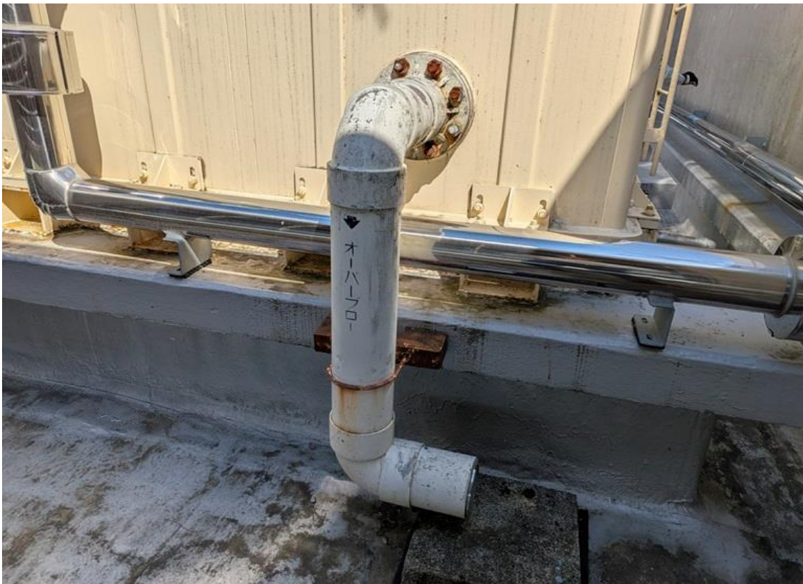
10揚水管およびオーバーフロー管（南面）
