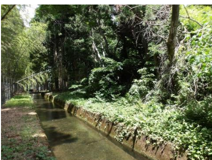
老朽化した用水路 （施工前）
