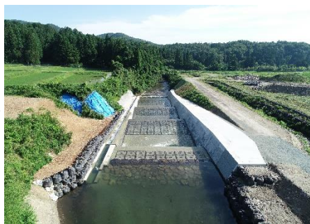
鴨川地区農業用河川工作物応急対策事業 落差工（施工完了後）
