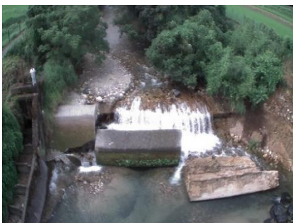
大雨により旧農業用水取水堰が崩壊（施工前）
