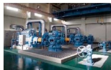
ハード対策の例 高効率電動機への更新による 省エネルギー化
