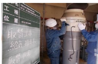
前処理室排気ファン更新
