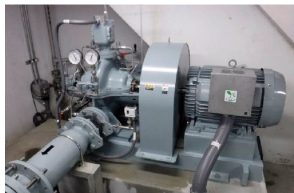
用水需要に応じて流量を調整できるポンプへの更新
