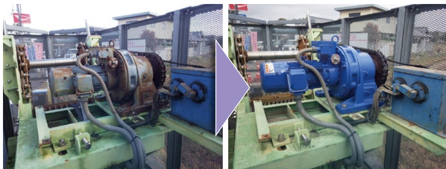
原動機の更新 (竜王町)
