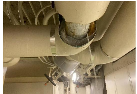
空調配管老朽化による水漏れ
