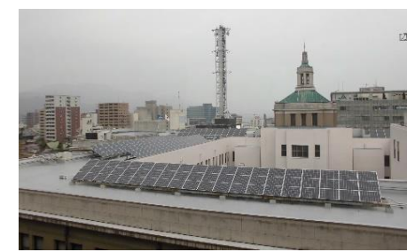
※県本庁舎における太陽光発電設備
