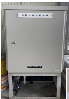
多項目水質計器 (濁度・色度・残留塩素)
