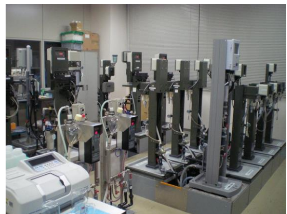
水質計器室（吉川浄水場）
