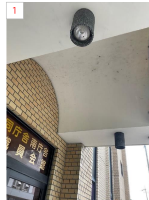
シーリングライト:LGW51505LE1×2台
