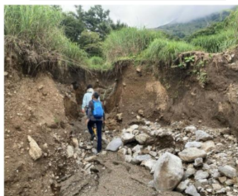
降雨により拡大した浸食溝
