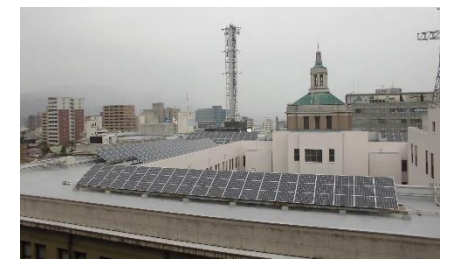
※県本庁舎における太陽光発電設備
