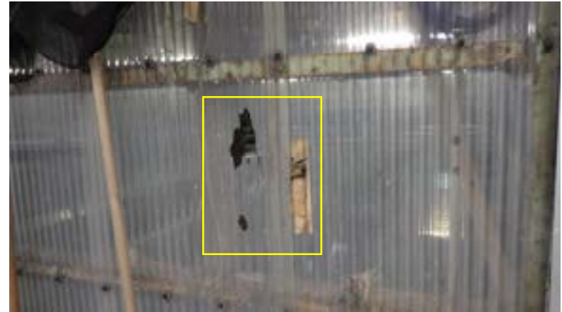
修繕方法 共通/ア 波板の破損による開口部(穴)
