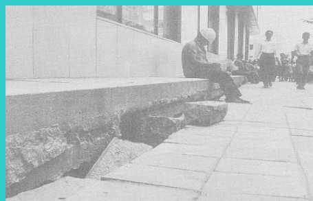
地盤沈下によるビルの蹴上がり
