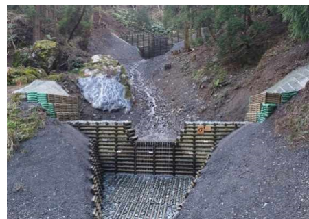
治山：溪間工(治山ダム) (大津市別所国有林)
