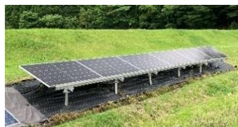
農道の法面を活用した太陽光発電
