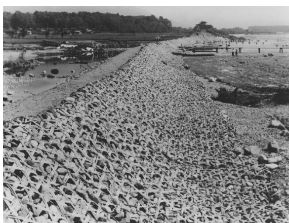
決壊した堤防の復旧（昭和 13 年）
