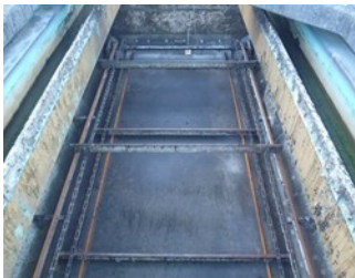
湖南中部浄化センター 水処理施設腐食状況
