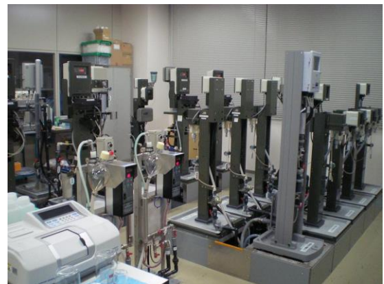
水質計器室（吉川浄水場）
