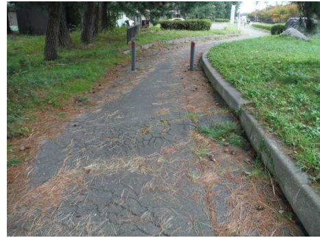
樹木の根による舗装の隆起
