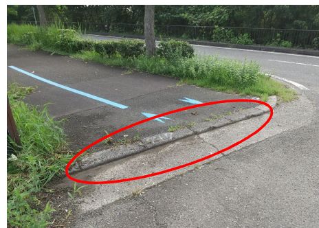
巻込み部の段差
