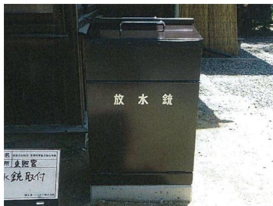
消火設備 放水銃の設置
