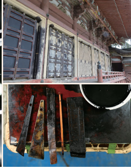
上)修理前の建具の破損状況手前が棧唐戸、奥4間が蔀戸 下) 漆塗で使う道具
