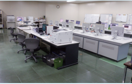
中央監視室 処理場とポンプ場の監視および運転制御をします。
