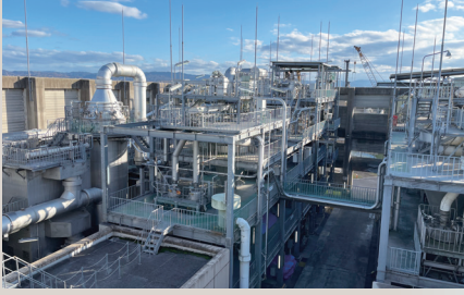
⑩焼却炉 脱水したドロ(脱水汚泥)を焼却して灰にします。 ※湖西浄化センターでは炭化による燃料化、高島浄化センターではコンポスト化により汚泥の有効利用をはかっています。
