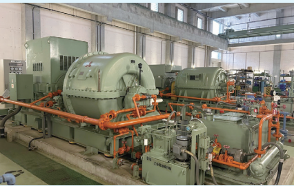
送風機 下水を処理する際に必要な酸素を供給するため、生物反応槽に空気を送ります。
