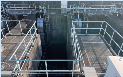
⑤急速砂ろ過池 最終沈殿池からの上澄み水を消毒後、砂の層を通ることによって最終沈殿池で除去されなかった浮遊物を取り除きます。
