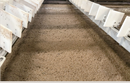
⑧汚泥濃縮(ベルト濃縮) 筒状につながって回転する網目状のベルトの上にドロを乗せて水分を落としながら、濃縮させます。
