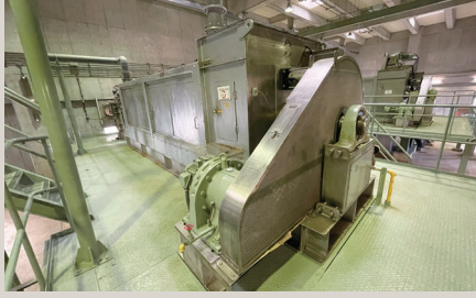
⑨脱水設備(スクリュースプレス脱水機) 濃縮されたドロを金属製の筒に押しこみ脱水し、取扱いやすくします。
