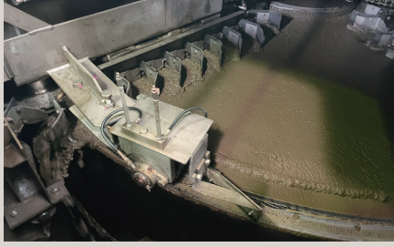
⑦汚泥濃縮(常圧浮上濃縮) 気泡を生成し、気泡にドロを吸着させ浮上させることで水とドロを分離させます。
