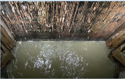
①スクリーン・ポンプ室 下水管から流入してきた浮いている大きなゴミはスクリーンで取り除きます。
