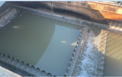
②最初沈殿池 スクリーン・ポンプ室より送られてきた下水を1時間ほどかけてゆるやかに流します。この間に沈殿しやすいドロなどの固形物の大部分を沈殿させ、かき寄せて汚泥濃縮槽に送ります。
