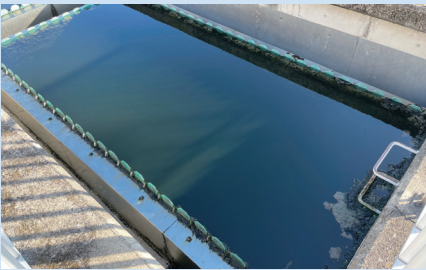
④最終沈殿池 綿毛状になった活性汚泥は底に沈み、きれいな上澄みの水が得られます。この水は急速砂ろ過池へ、活性汚泥は返送汚泥として生物反応槽へ送り、余分な汚泥は最初沈殿池の汚泥とともに汚泥濃縮設備へ送ります。
