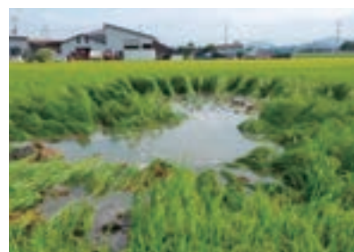
管水路の破損による農地の陥没
