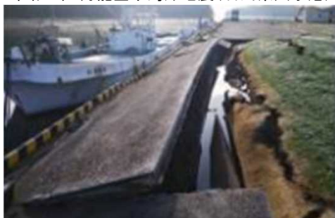
令和6年1月能登半島沖地震(石川県穴水港)
