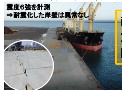
令和3年2月福島県沖地震(福島県相馬港)
