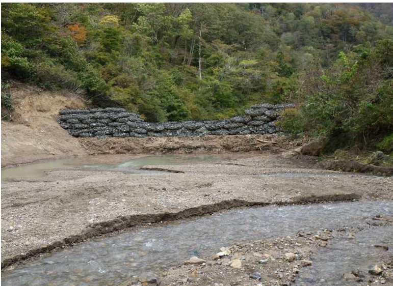
沈砂池（パワフルユニット）
