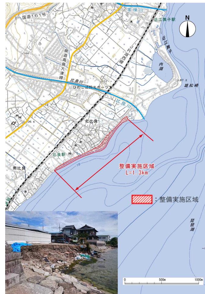
台風による侵食被害
