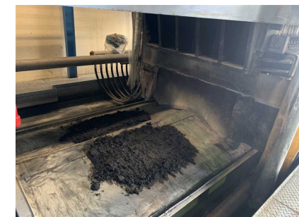
機械脱水汚泥
