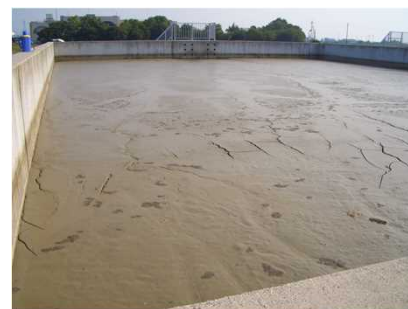
汚泥張込み 1箇月後
