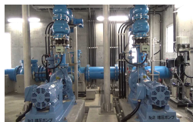
石部増圧ポンプ場
