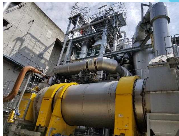
汚泥燃料化施設 (湖西浄化センター)
