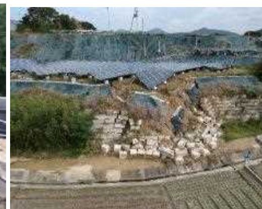
法面保護工が崩れて流出した事例
