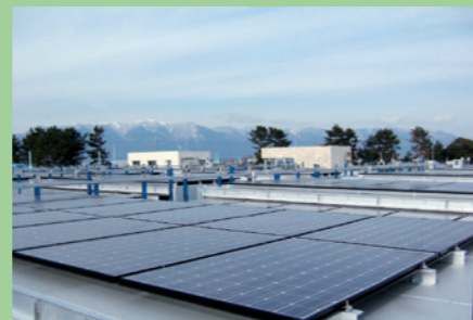
太陽光発電システム (吉川浄水場)
