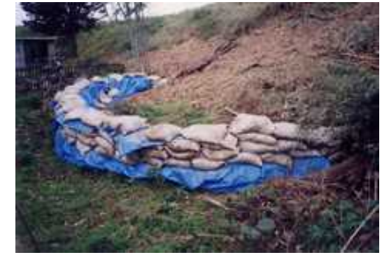
平成10年台風6、7号姉川堤防漏水
