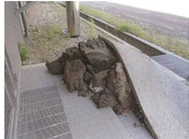
地中配管破裂によるケキ漏れ
