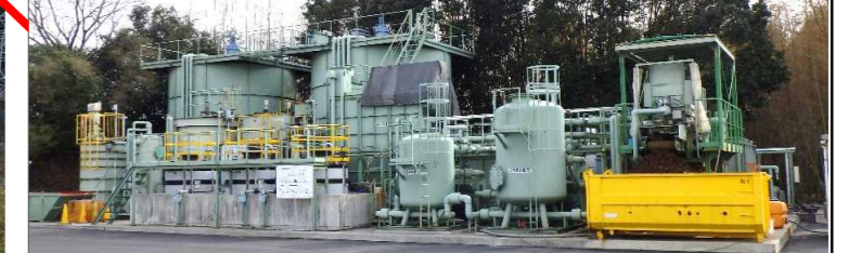
新設、既設(移設)の水処理施設
