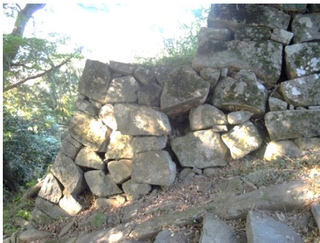
図 5-26 崩落寸前の石垣
