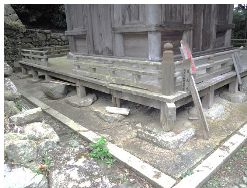
図 5-2 摠見寺三重塔劣化状況
