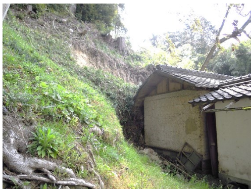
図 5-1 造成地の崩落
