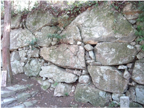
図 5-9 石垣劣化（伝本丸取付台）
