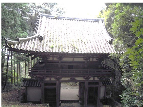
図 5-3 摠見寺二王門屋根瓦ずれ
