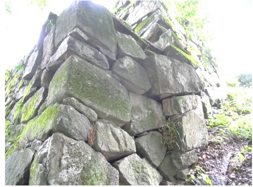
図 5-8 石垣劣化（摠見寺跡）
