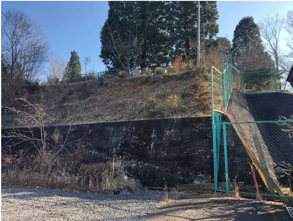
図 8 信楽中学校南側のがけ崩れ箇所に整備されたコンクリート擁壁
