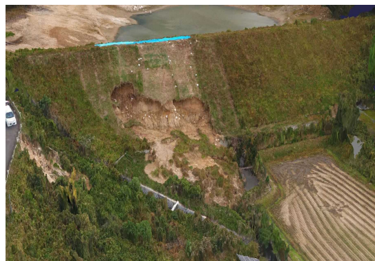
図VI-4 貯水位の上昇によりパイピング破壊したため池（他県例）
