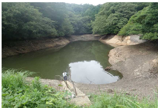
図VI-3 期間的に低水位管理をしているため池（他県例）
