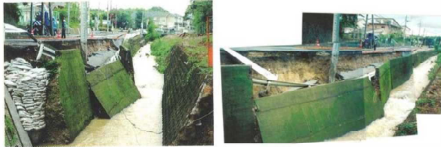
高橋川 1999(H11)年6月 梅雨前線による大雨の被害(建部大社裏)
