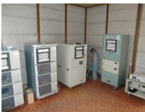
大気自動測定局の内部
