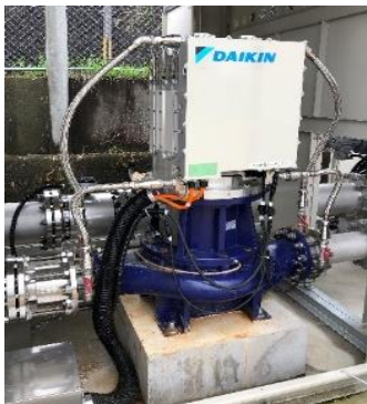
管水路用マイクロ水力発電システム (近江八幡市長福寺町)
