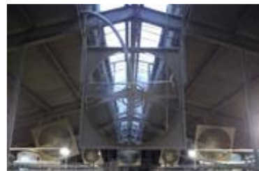
大型扇風機の設置
