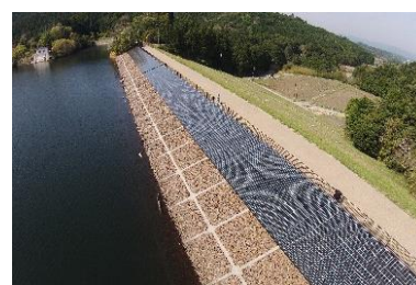
ため池法面での太陽光発電の設置
