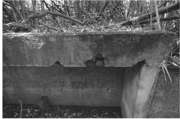
写真4 天蓋端部の支持材痕
