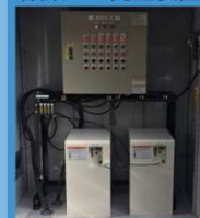
酸素ガス発生装置
