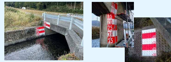
簡易量水標の設置状況
